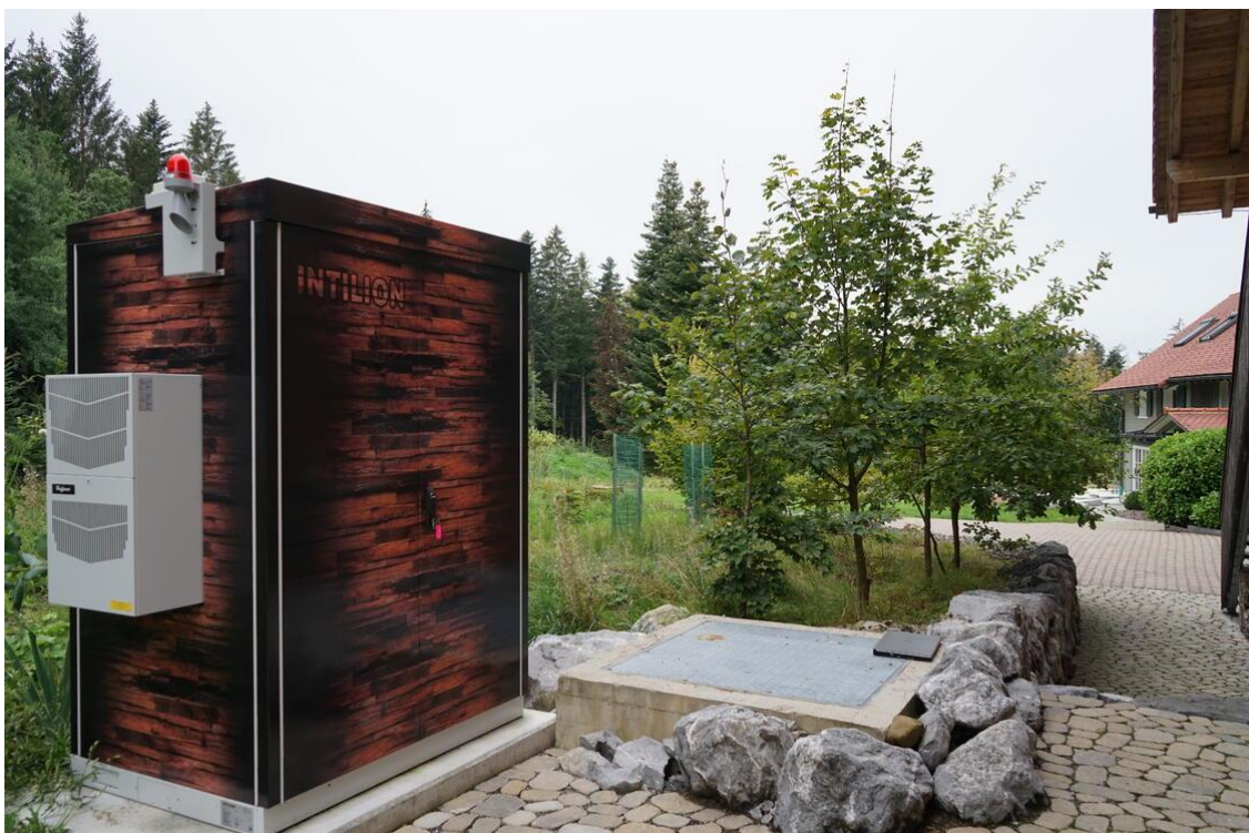
Springt bei Netzausfall ein: Ein INTILION | scalebloc versorgt ein Berghotel mit Strom.
